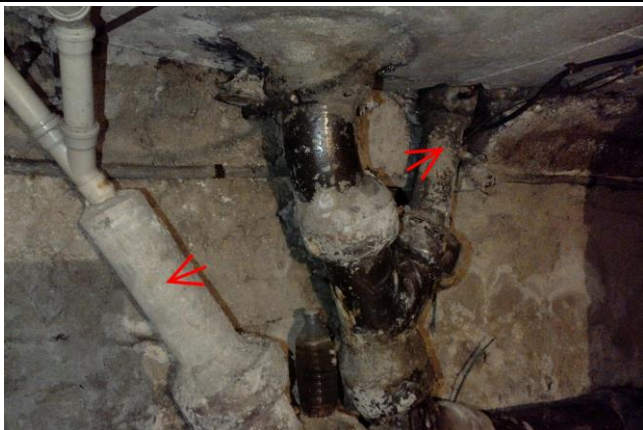
001 : amiante ciment cave
