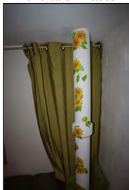
Photo N° 118 AMIANTE CIMENT - 2ème-Chambre 4 Conduits de fluide Ventilation haute
